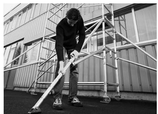
Bild 3: Sicherung des Rollgerüsts gegen Kippen.
